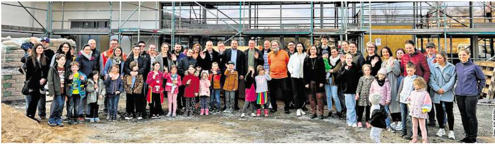
Zu sehen sind die Teilnehmer der Baustellenbegehung der neuen Grundschule Mainblick Schonungen, darunter viele junge Familien.
